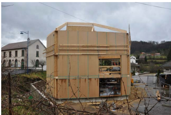
Figure 22: La Ruche de Tendon : vue du chantier de construction, Haha architecture, 2011 (© Haha).
